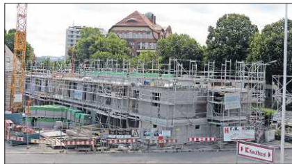
Am neuen Wohnquartier der Bau AG an der Goethestraße sind die Arbeiten in die Gänge gekommen.
